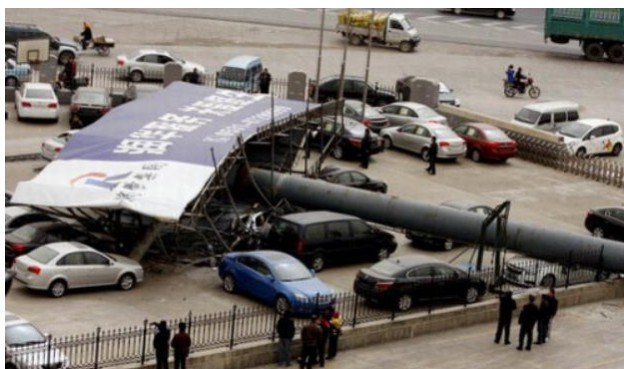
Рисунок 7 – Зруйнована конструкція білборда (руйнування біля фундаменту)
