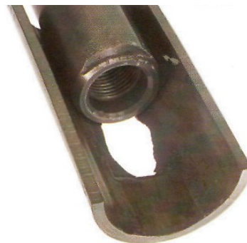
Рисунок 3 — Пошкодження від удару муфти об НКТ
